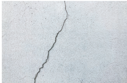
基礎のひび割れから
