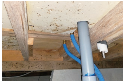
配管スリーブなどの隙間から
