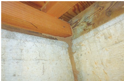
基礎用セパレーター金具などの隙間から
